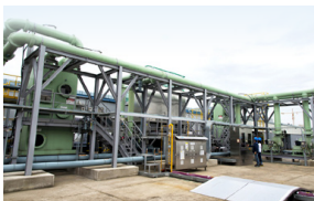
반도체 공정가스 처리 설비
